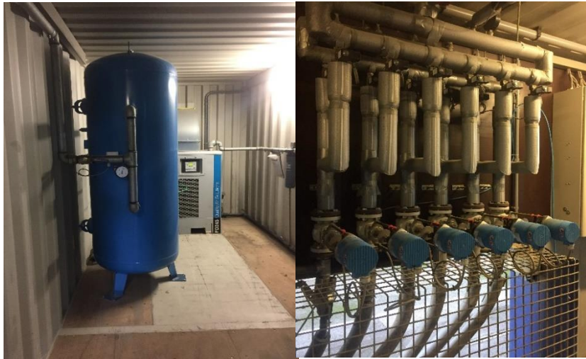
Abbildung 11: Blick in die EcO2-Anlage: Druckbehälter und im Hintergrund Luftentfeuchter (links), Steuerung der Luftzufuhr in die Zellen (rechts)
