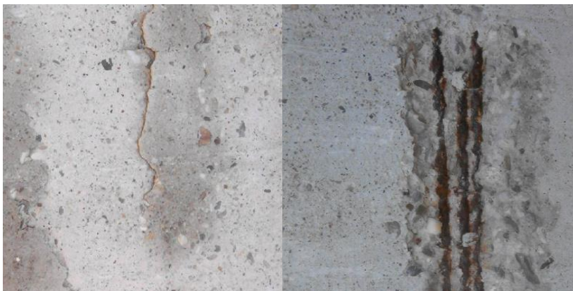
Abbildung 8: Risse und Rost an der Fassade
